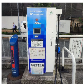
図 3-3 EVスタンド(区役所附属駐車場)
