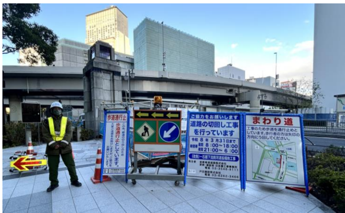
一石橋歩道通行止状況
