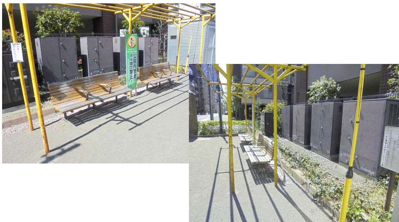
図 3-6 公共用地を活用した地上機器設置事例（勝どき二丁目児童遊園）
