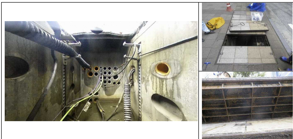
図 6-7 特別区道中月第 801 号線の整備済の特殊部内部の劣化状況
