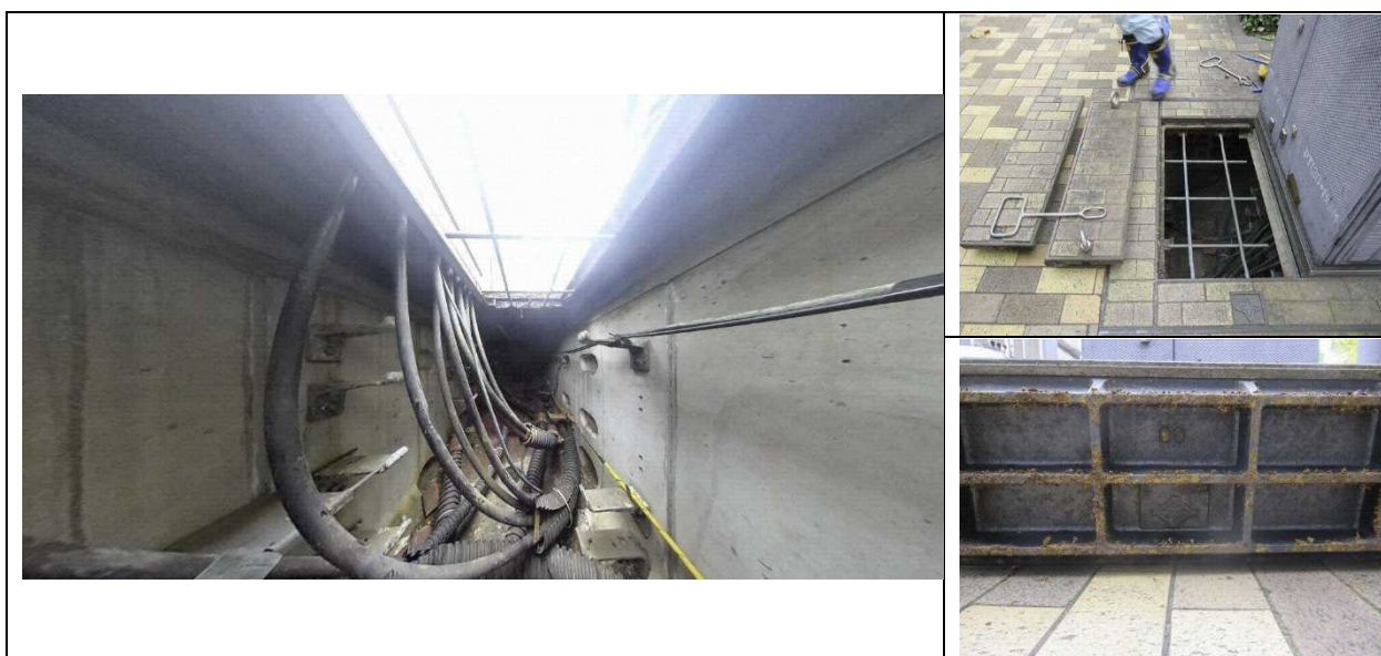
図 6-6 特別区道中京第 407 号線の整備済の特殊部内部の劣化状況
