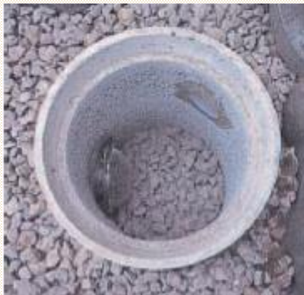
写真 雨水浸透ます
